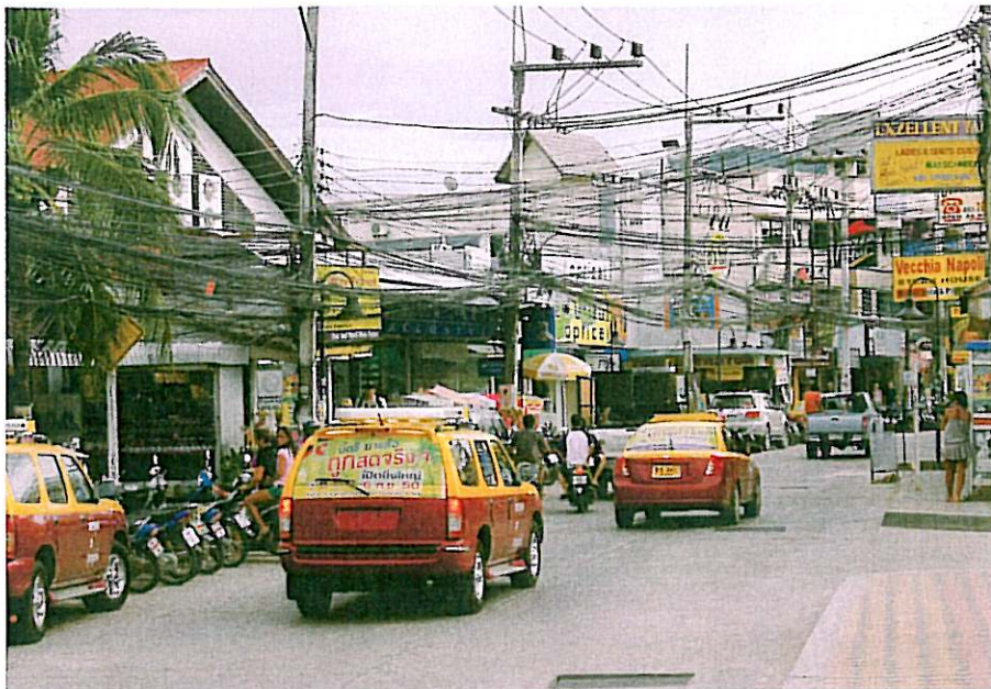
KOH SAMUI er et virvar av dårlige veier og elektriske ledninger i floke. Her fra hovedgaten i Chaweng.
